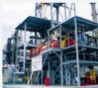
実証化プラント
