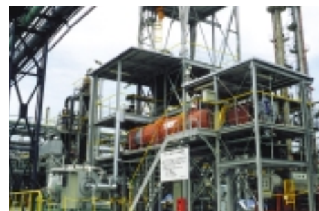
廃塩ビリサイクル実証プラント
