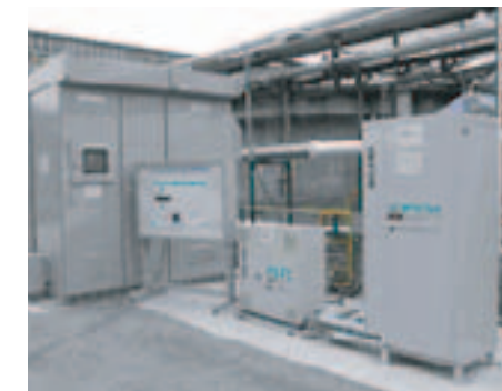
電解工場で製造される水素をパイプラインで直接、燃料電池に供給する実験プラント設備
