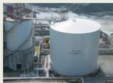
写真廃液受け入れ設備
