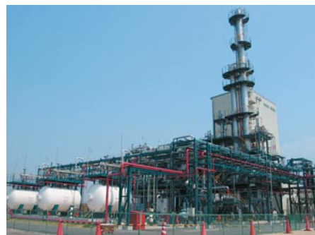
太陽電池用多結晶シリコン実証プラント
