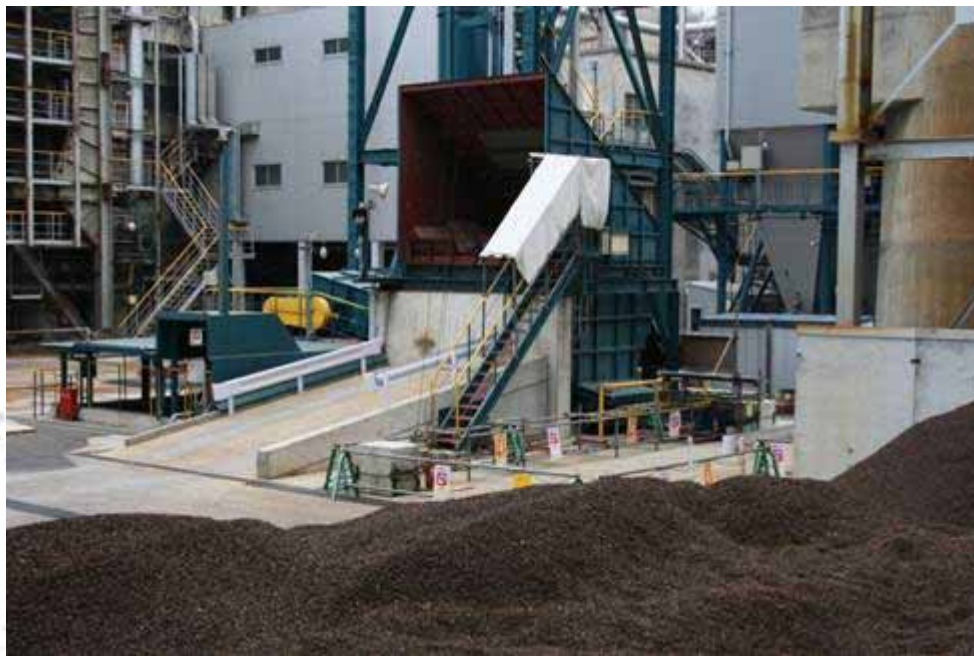
中央発電所7号ボイラーPKS投入設備
