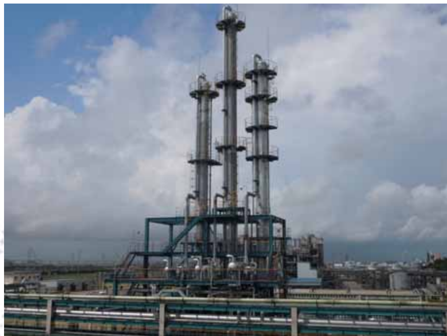
完成したTCS・STC高純度化設備
