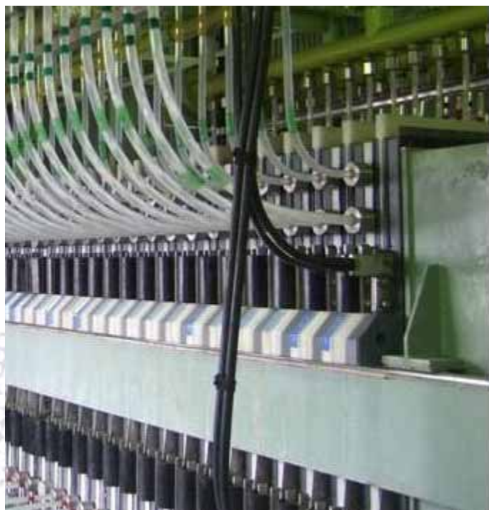
最新鋭の現像液製造設備
