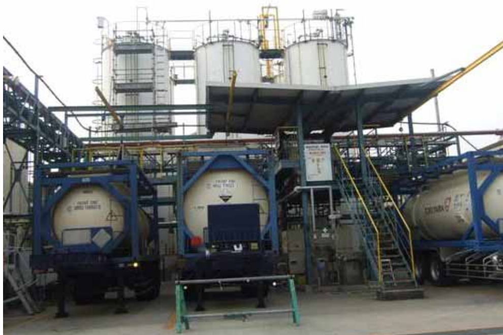
徳山製造所の現像液出荷設備
