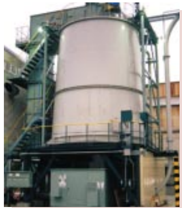
廃プラ燃料化プラント
