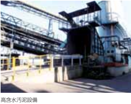
高含水汚泥設備
